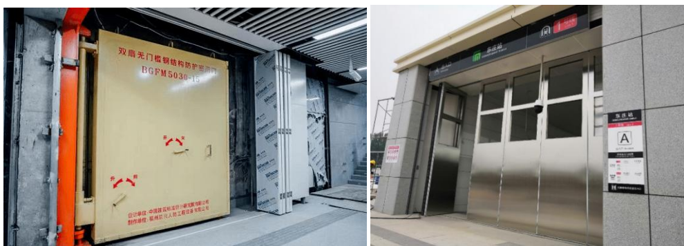
图3 地铁防淹门实景图（左：福州市；右：石家庄市）
